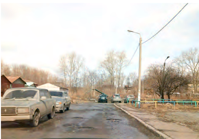
Так выглядела дорога до ремонта...
